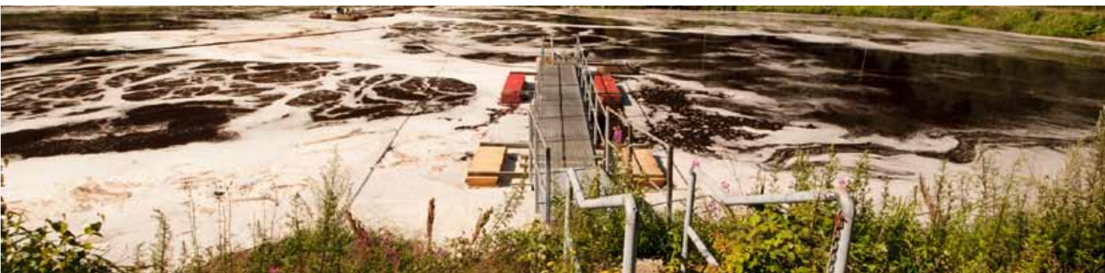
Renseanlegg Støleheia - luftlagune
